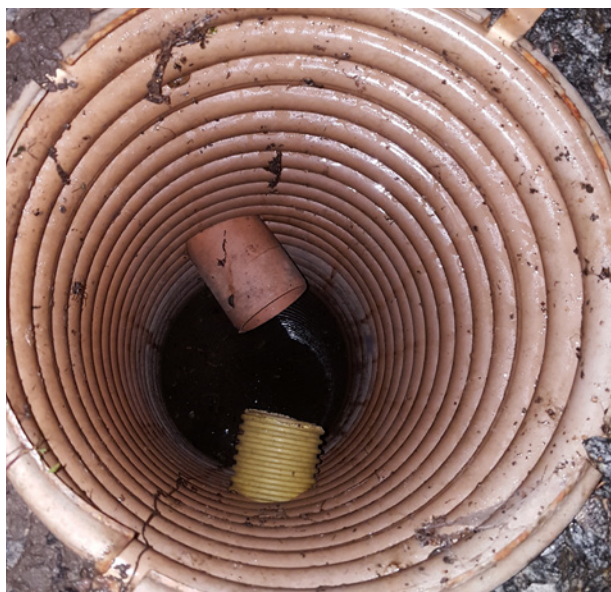
Tillsynsbrunn med sandfång i botten.
